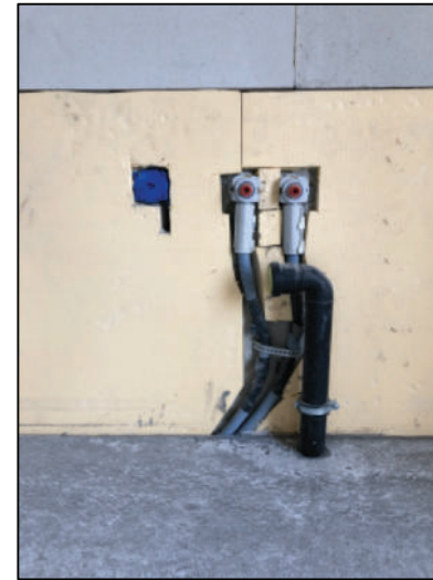
Sanitäre Installationen Ablauf kommt aus dem Boden
